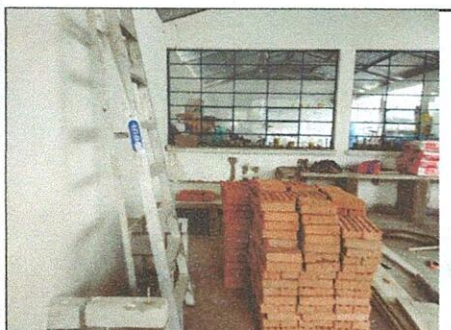
Foto 5: Espacio para estufas industriales y poyotón de concreto.
